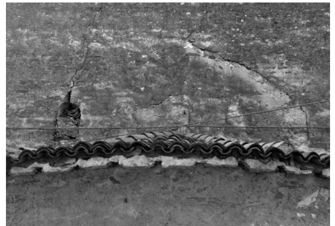
25. Balocco, San Michele. Serie di cinque monofore centinate nel timpano della testata est.
