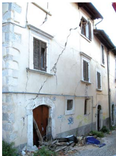
Fig. 2. L'Aquila. Edifici nella zona rossa (Foto: R. Afferni).
